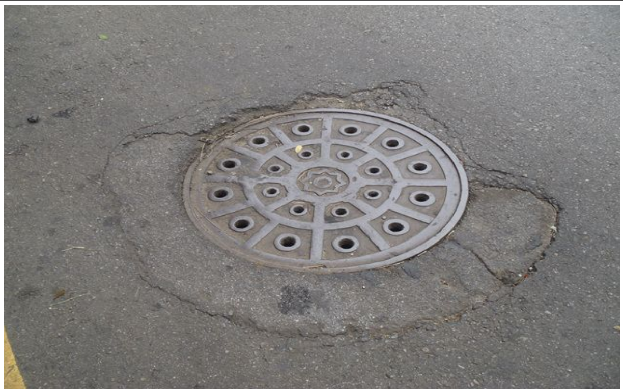
포장부 J14~J15 맨홀부 주변 파손
