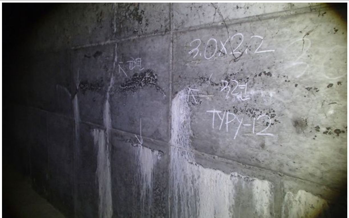
Type-12 J110 백태 및 균열
