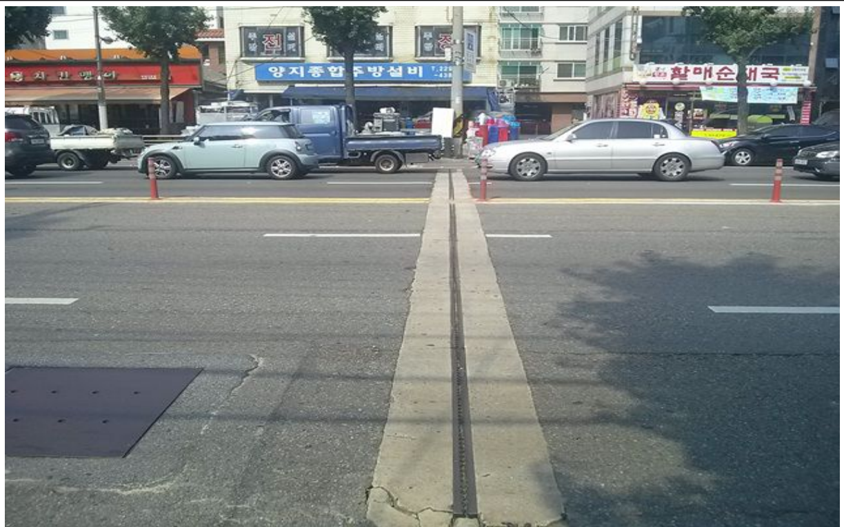
신축이음 J77 후타재 파손
